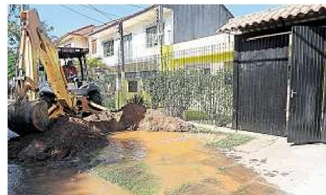
Obras não impediram acúmulo de água na Rua Fernando Pessoa
