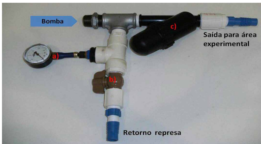
Figura 19: Sistema acoplado na saída da bomba para controle da pressão da água no sistema de irrigação; manômetro (a); válvula para controle da pressão do sistema (b); filtro de água (c).
