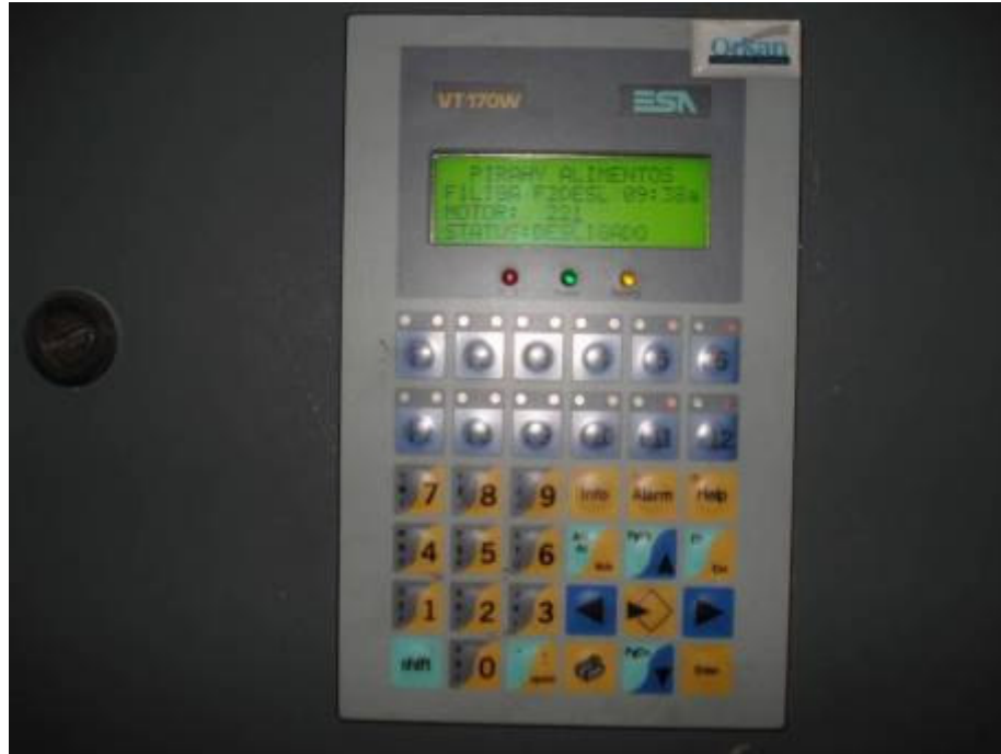
Figura 43 – Quadro de comando para acionamento de truas e elevadores. Fonte: O autor (2008).
