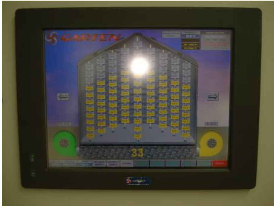
Figura 45 – Quadro de controle do sistema de termometria em silos de armazenamento.
