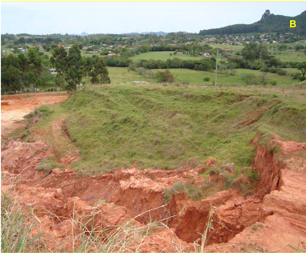
Figura 31 – Detalhe B: movimento de massa próximo à Dutovia OSCAN Fonte: o autor (2008)
