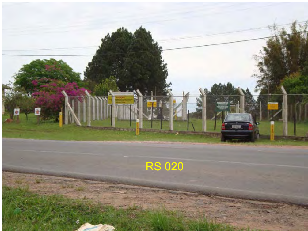
Figura 24 – Cerca protegendo a válvula do sistema de oleodutos OSCAN na sua intersecção com a RS 020 Fonte: o autor (2008)
